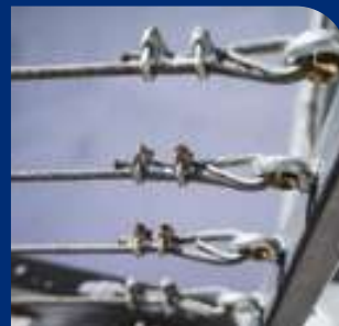
Cables y retenidas
